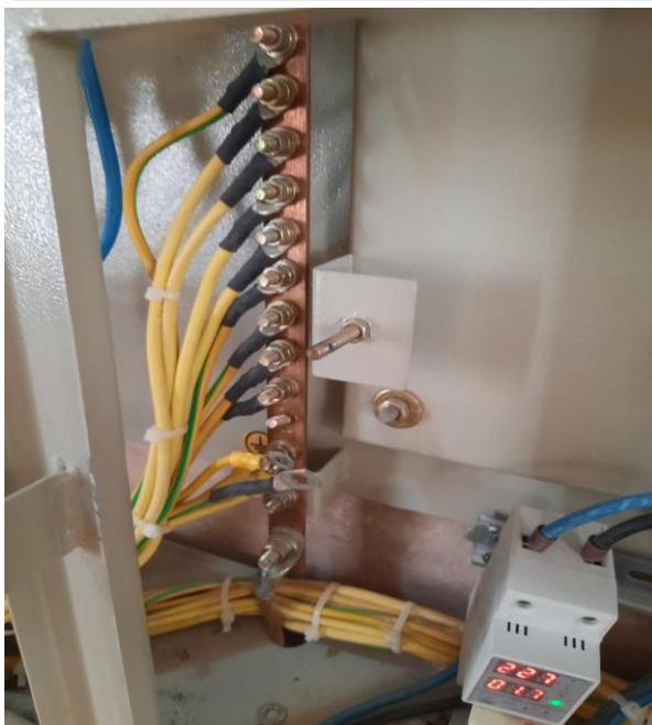
نمای شینه یا باس بار BUS BAR هادی حفاظتی در تابلو اصلی حداقل سطح مقطع 50 میلی متر مربع در این پروژه سطح مقطع 20*5 معادل 100 میلی متر مربع
